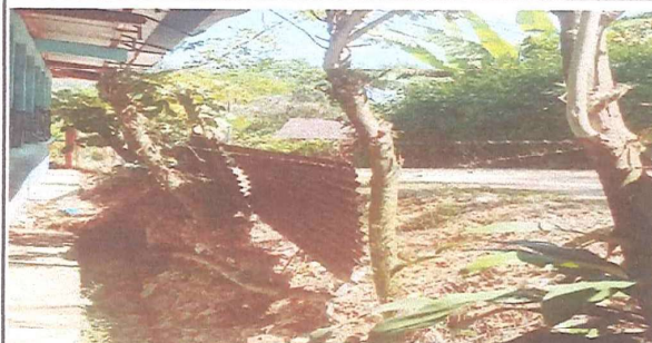
Foto 1: CAMINO DE LA COMUNIDAD ADENTRANDO AL PERÍMETRO DE LA ESCUELA DERUMBÁNDOSE Y TAPANDO LA CUNETA DE LA AGUA EN EL ESTABLECIMIENTO.
