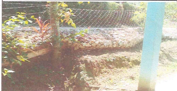
Foto 2: SOLO UNA MALLA DETENÍA PARTE DEL CAMINO LO CUAL PELIGRABA AL TRANSITAR MUCHOS MEDIOS DE TRANSPORTE
