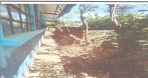
FOTO 3 LA MALLA ESTABA CAYENDO INCLINÁNDOSE YA SOBRE LAS AULAS
